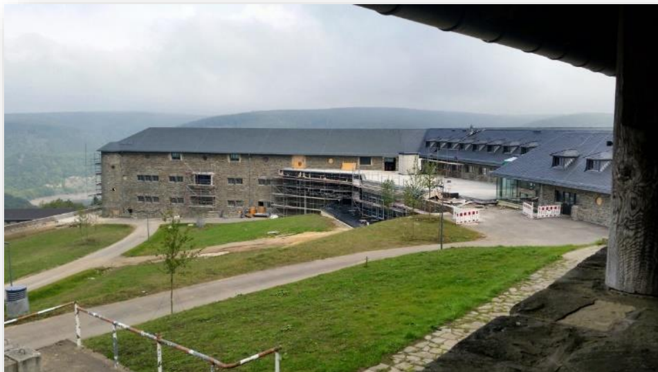
Aussicht von der Ordensburg ins Urfttal, im Hintergrund die Bauarbeiten für die neue Außengastronomie (Foto: Hubert Kreutzkamp)
